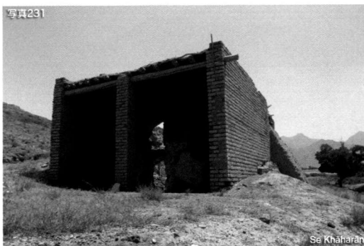
写真231 Se Khāharān. 廟正面近くから。正面部分は新しく煉瓦で補修が行われているのが見て取れるが、壁は落ち、廟内への入り口の扉は既になくなっていてる。
