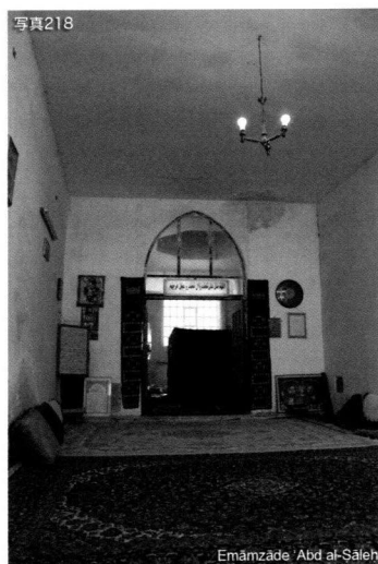
写真218 Emāmzāde 'Abd al-Šāleh. 廟の中。扉の向こうにザリーが見えている。あちこちに雨漏りのようなしみができている。週に一度、短時間しか扉を開けないためか、廟内全体が湿っぽい。
