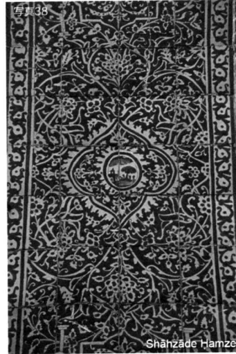
写真38 Shāhzāde Hamze. 正面エイヴァーンに貼られたコバルト色のタイル。剥落を防ぐため、文化遺産観光庁により補修工事が行われている。
