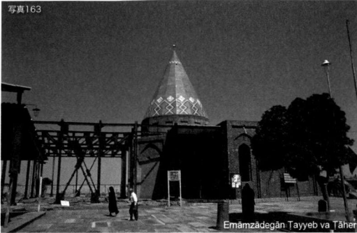
写真163 Emāmzādegān Ṭayyeb va Ṭāher。本来の廟はドームの下の塔状の部分だけだが、そこにホセニーエやマスジドを増築するための工事が行われている。そのため、墓地の一部が掘り返され、整備が行われている。
