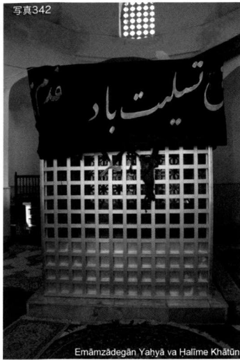
写真342 Emāmzādegān Yahyā va Ḥalīme Khātūn. 外観は仕上がっていないが、ハラム内は漆喰で壁が仕上げられている。しかし、既に雨漏りのしみができている。
