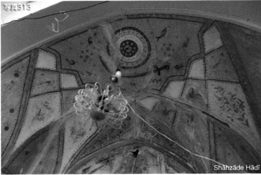
写真313 Shāhẓāde Hādī。廟の正面エイヴァーン上部。花鳥図で飾られているが、雨漏りによるひび割れやしみで破損が見られ始めている。それほど古いものではないからと、保存には消極的な様子。
