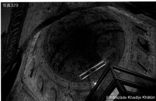
写真329 Emānzāde Khadije Khātūn. ハラム天井ドーム。亀裂が入ったり漆喰が剥落したりしている部分もあるが、シンプルで落ち着いた雰囲気気の装飾。
