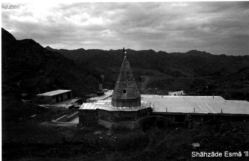
写真305 Shāhzhāde Esmā 'īl。2006年。廟の後背の丘の上から。建物部分の屋根はイーゾガームによって雨雪 の対策が行われているが、ドームはオリジナルのタイルがほとんど落ちてしまい、寂しい状態になっている。
