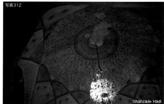
写真312 Shāh-zāde Hādī。ハラム天井。一部漆喰が落ちてしまっているが、彩色された紋様が覆われている。
