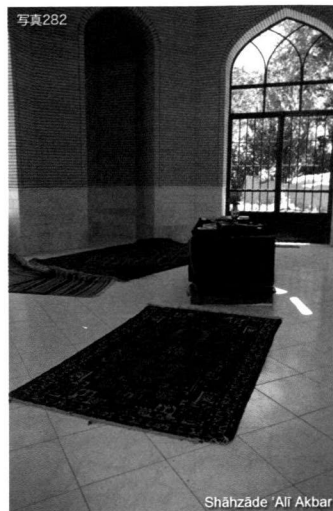
写真282 Shāhẓāde 'Alī Akbar. まだ窓は入っていないが、まだ未完成の外壁とは異なり、化粧タイルも床も貼られている。床にも埃はほとんど積もっておらず、誰かが訪れ、掃除をしていることが分かる。
