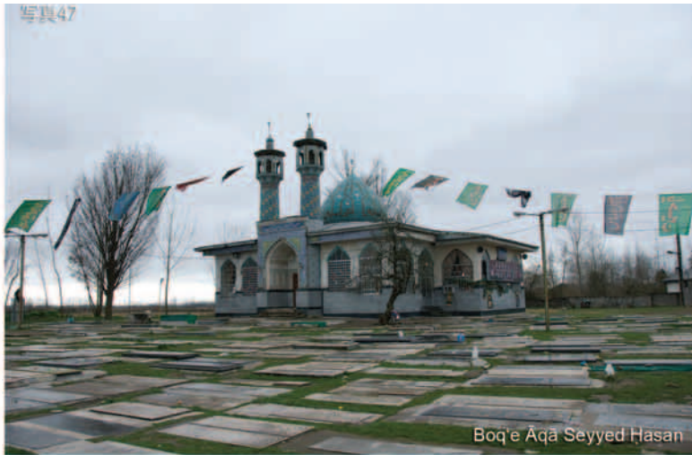
写真47 Boq'e Āqā Seyyed Hasan. 広い墓地の中に建つタイル張りの廟。アルボルズ以南のように美しいタイルで廟を飾ることは、ギーラーンの人々にとってもあこがれてあるが、多雨多湿の気候のため、タイルが剥落したり汚れたりしやすいのが悩みとのこと。
