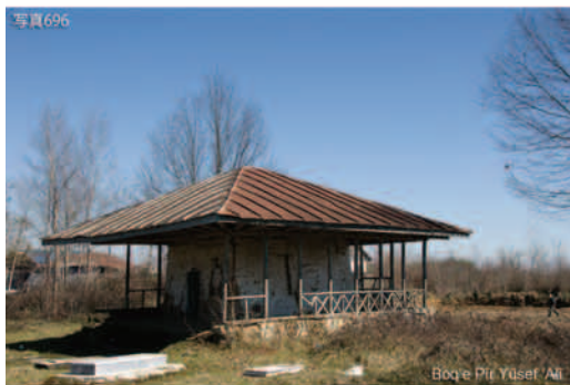
写真696 Boq'e Pir Yūsef 'Alī, 村はずれの墓地の中に建つ廟。大きなエイヴァーンと張り出した屋根が印象的。遠目に見ても、エイヴァーンの手すりが壊れたり、壁が落ちているのが取れる。
