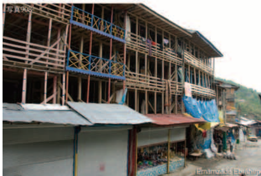
写真908 Emānzāde Ebrāhīm. 廟の周囲に立ち並ぶ土産物屋兼簡易宿泊施設。土産物屋の二階以上は、床と手すりがあるだけの吹きさらしの宿となっている。冬はシートを張って雨が吹き込まないようにするが、夏は開放してしまう。夏になるとこの柱や手すりはカラフルに塗られ、賑やかな門前市に彩りを添える。
