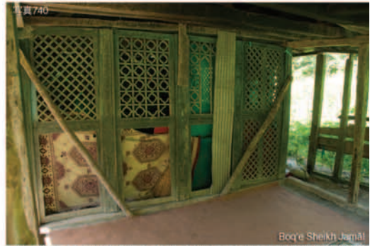
写真740 Boqe Sheikh Jamāl. エイヴァーン側のハラムの壁。壁の下部の格子が壊れてしまい、布を貼って応急措置を取っている。こうした格子の壁はフーマンのいくつかの廟で見られるものだったが、今はほとんど残っていない。
