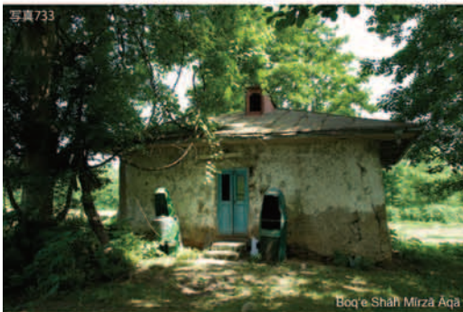
写真733 Boq'e Shāh Mirzā Āqā. 木々に囲まれた古い廟。土の壁にひびが入り、上に塗られた漆喰も傷んでしまっている。
