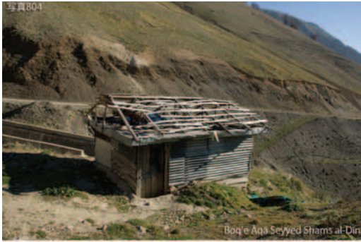
写真804 Boq'e Āqā Seyyed Shams al-Dīn, 廟はトタンをはって壁として、屋根も葺いてあったはずなのだが、すっかりはがれてしまい、骨組みだけが残っている。
