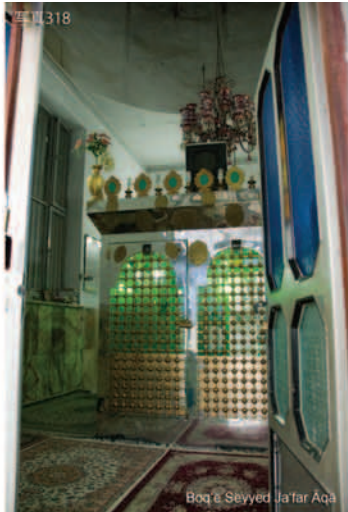
写真318 Boq'e Seyyed Ja'far Aqā. ハラムの女性用スペース。壁の腰板には大理石が張られ、絨毯が敷き詰められている小さなスペース。ザリーの中にある緑の蛍光灯が照明の代わりになっている。
