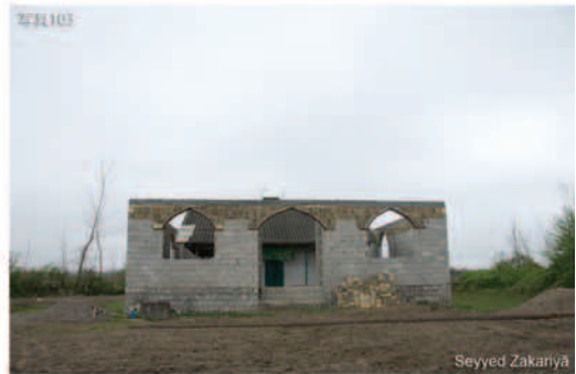
写真103 Boq'e Seyyed Zakariyā. 水田の中を通り、小さな砂の空き地に出ると、古い廟を覆うようにコンクリートブロックの壁が建てられているの見える。レンガやコンクリートブロックが置かれているが、工事が進められているように見えない。
