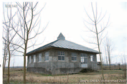
写真140 Boq'e Sheikh Mohammad Zeid. 敷地内から見た廟。それほど大きくない敷地内には墓地は見られない。コンクリートがむき出しになったままの外壁には地面からの湿気の跡がはっきりしている。それを避けるため、階段の高さまで床が上げられていることが分かる。
