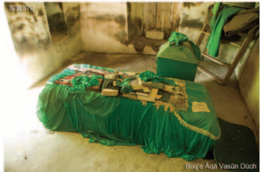
写真870 Boqe Aqa Vasun Duch. 廟内は、雨のシミが壁一面に見られる。床も張られておらず、土のまま。しかし、廟内は清掃が行き届き、土で作られた墓石を覆う布も埃をかぶっていない。
