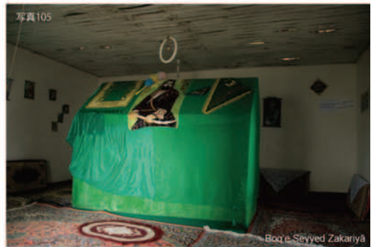
写真105 Boq'e Seyyed Zakariyā. 廟の中は掃除が行き届いているが、天井の板には隙間も見られ、改修が必要なが分かる。
